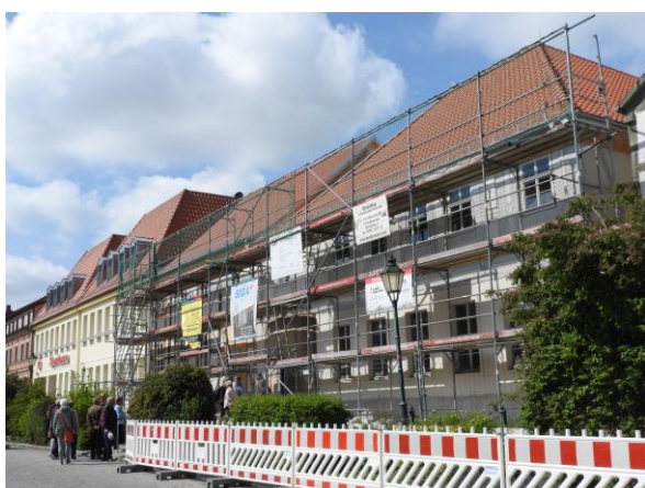
Ab Ende des Jahres werden die Häuser hoher Steinweg 17 und 18 das neue Angermünder Museum und auch die Tourist-Information beherbergen.
