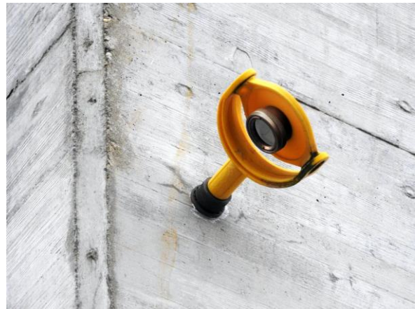
Bild 17: Solche Spiegel dienen zur optischen Vermessung und Überwachung des Bauwerkes.
