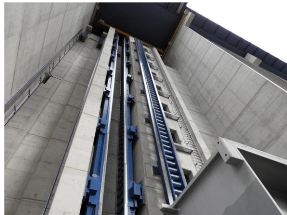
Bild 12: Der Antrieb des Troges erfolgt über vier große, elektrisch angetriebene Zahnräder, die in die vier Triebstockleitern eingreifen und den Trog heben und senken. Sie werden sowohl elektrisch als auch mechanisch synchronisiert. Jedes Zahnrad, Triebstockritzel genannt, wiegt 12,5 Tonnen.
