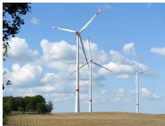
Im Jahr 2017 wurden im Windfeld Welsow fünf Servion-Windkraftanlagen mit je 3,2 MW Leistung in Betrieb genommen. Sie erreichen mit einer Nabenhöhe von 139 m und einem Rotordurchmesser von 122 m eine Gesamthöhe von rund 200 m.
